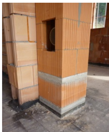
Prerušenie tepelného mosta pod komínom
