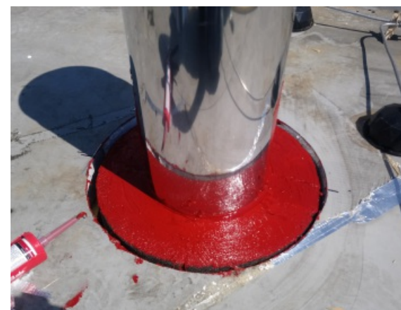
Komín v plochej streche s inštalovaným bezpečným prestupom
