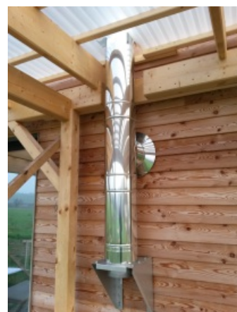
Nerezový komín založený na konzole
