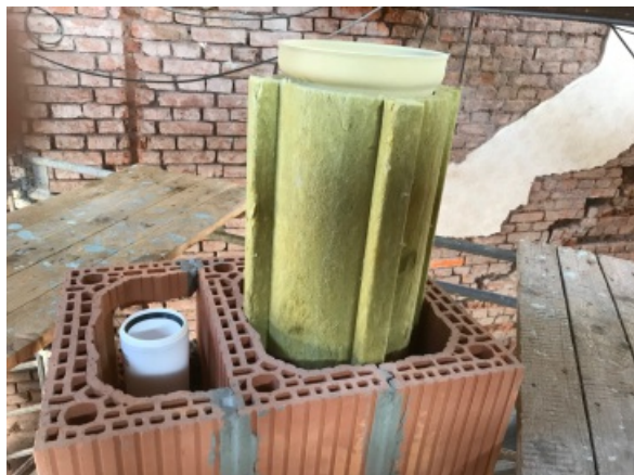
Dvojprieduch CIKO GAS v polovičnej šachtě spoločne s CIKO TEC
