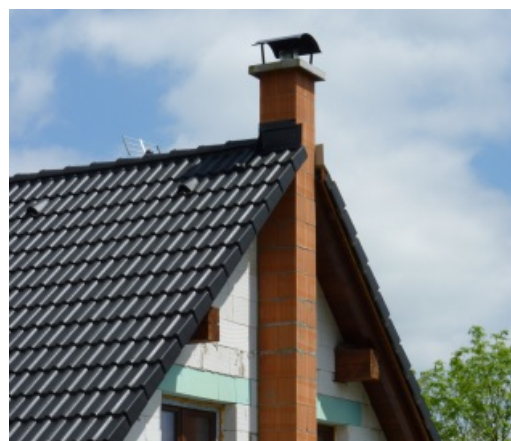
Fasádný komín s oblou strieškou a prívodom vzduchu
