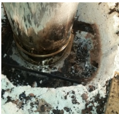
Následok chybné zaizolovaného prestupu komína stropom
